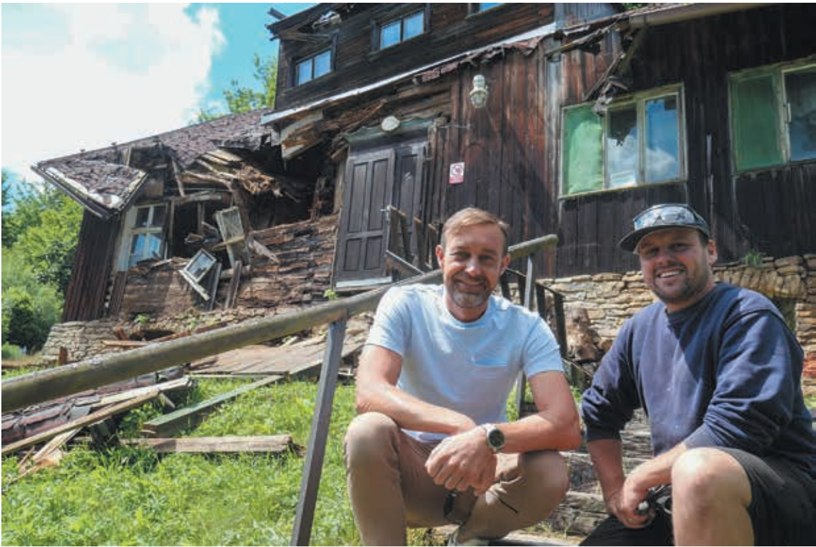
• Marek Bystron (z lewej) i Marian Łacek przed budynkiem na Bagińcu. Na drugim planie zawalony fragment obiektu. Fot. ŁUKASZ KLIMANIEC
